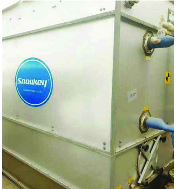
01 خزان المياه المبردة
